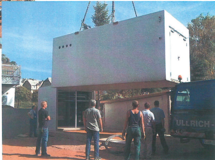
Aufstellung des BHKW in Burkhardtsdorf
